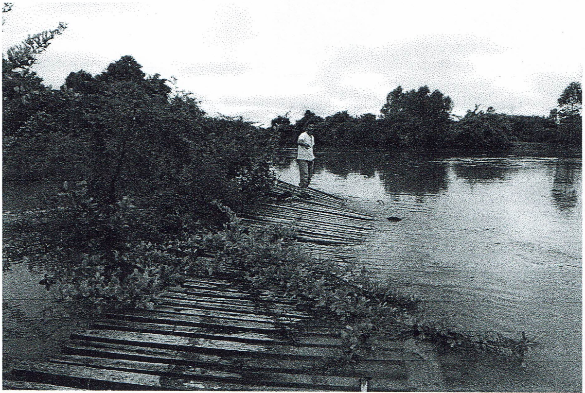
ภาพสะพานน้ำพัดพังเสียหาย
